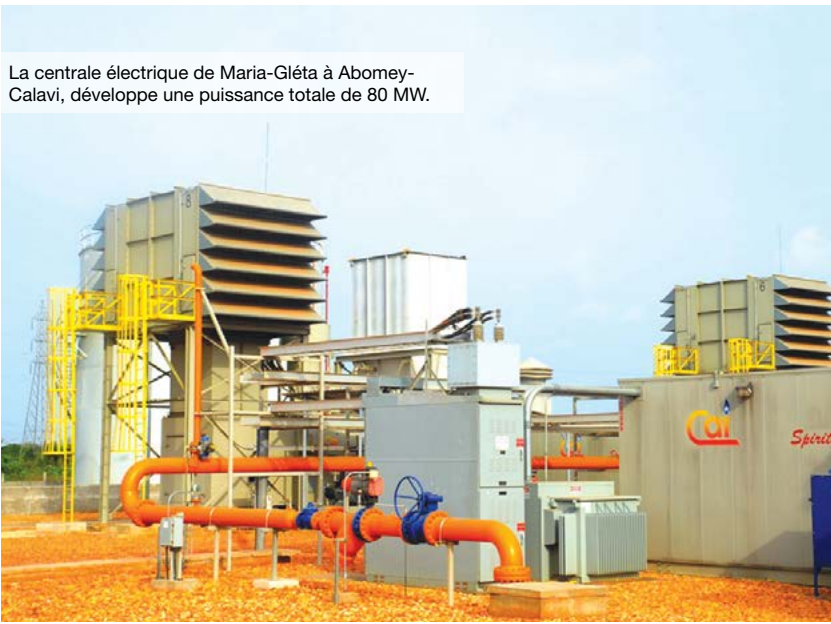
La centrale électrique de Maria-Gléta à Abomey-Calavi, développe une puissance totale de 80 MW.
